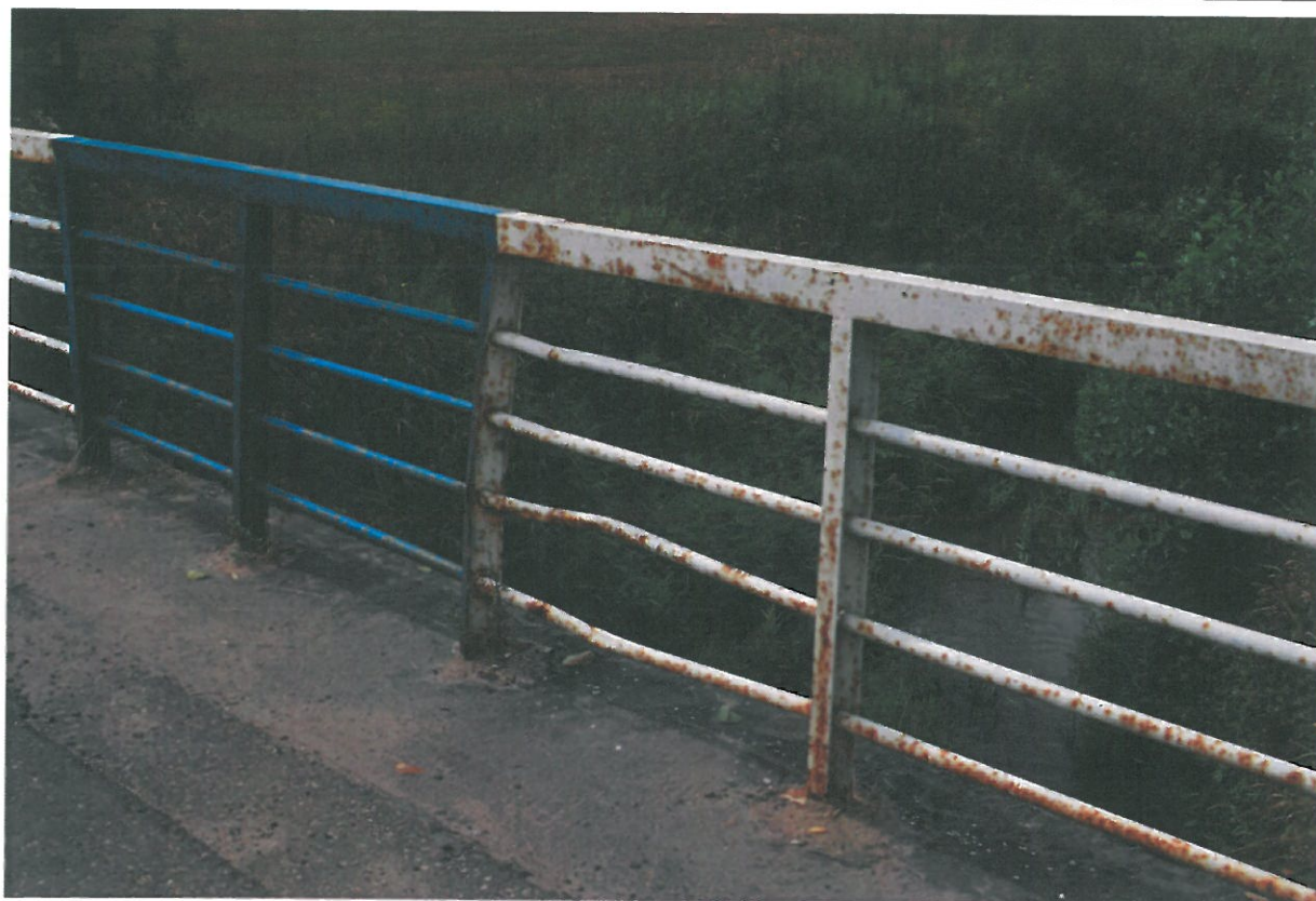
Fot. 9. Zniszczenie zabezpieczeń antykorozyjnych oraz korozja balustrady.
