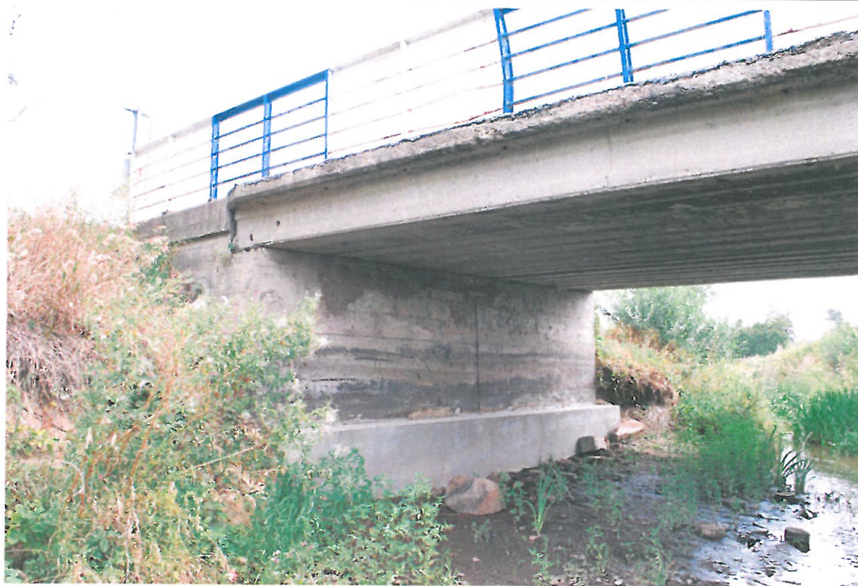
Fot. 15. Zanieczyszczenie przestrzeni podmostowej.
