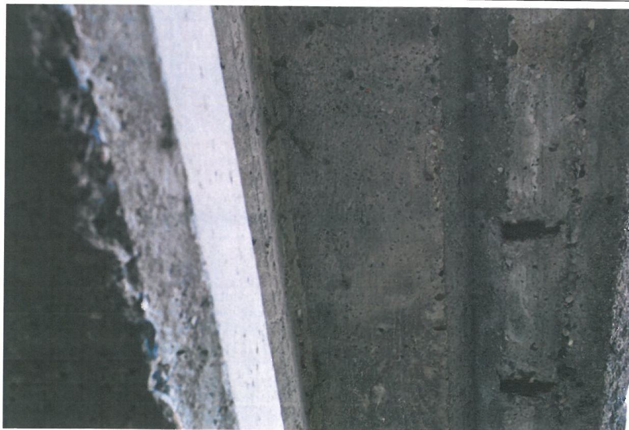
Fot. 12. Brak otuliny oraz korozja zbrojenia gzymsu.
