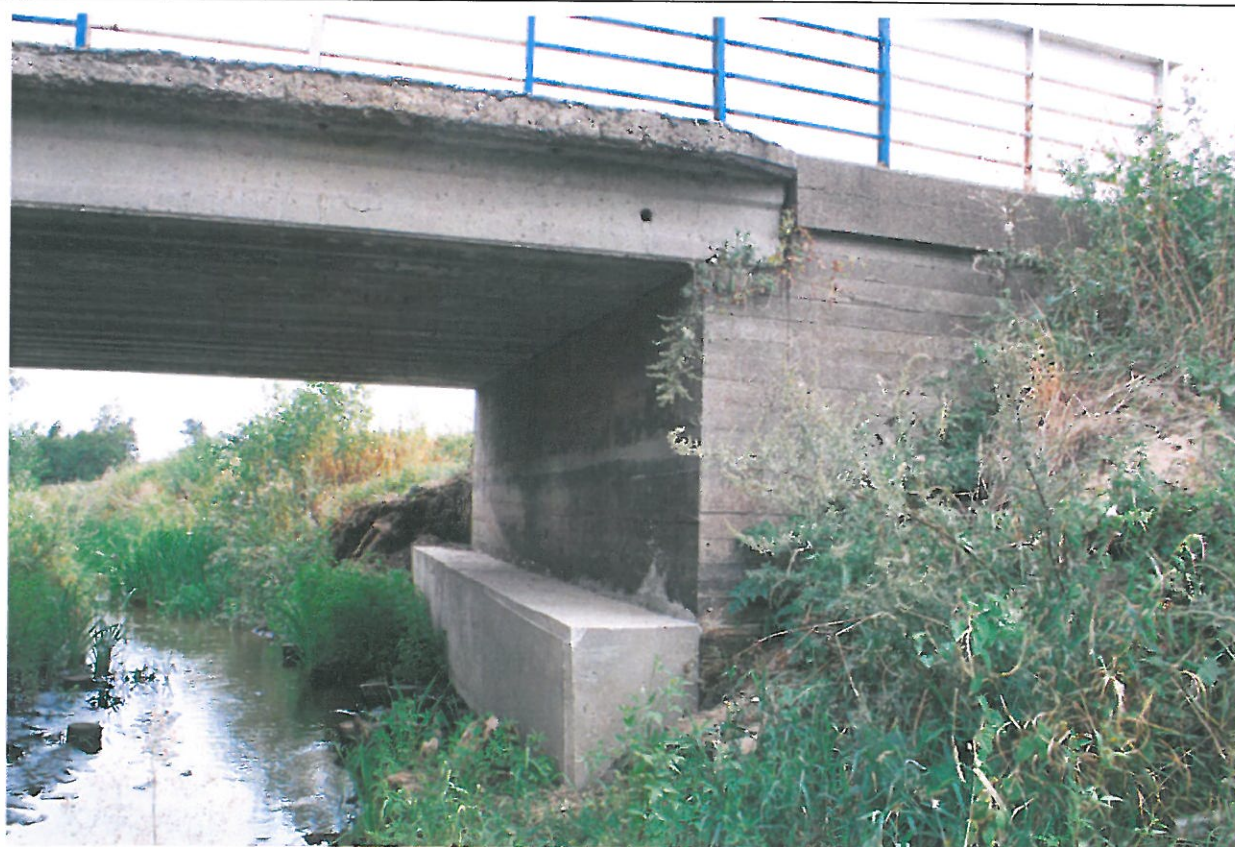
Fot. 16. Zanieczyszczenie przestrzeni podmostowej
