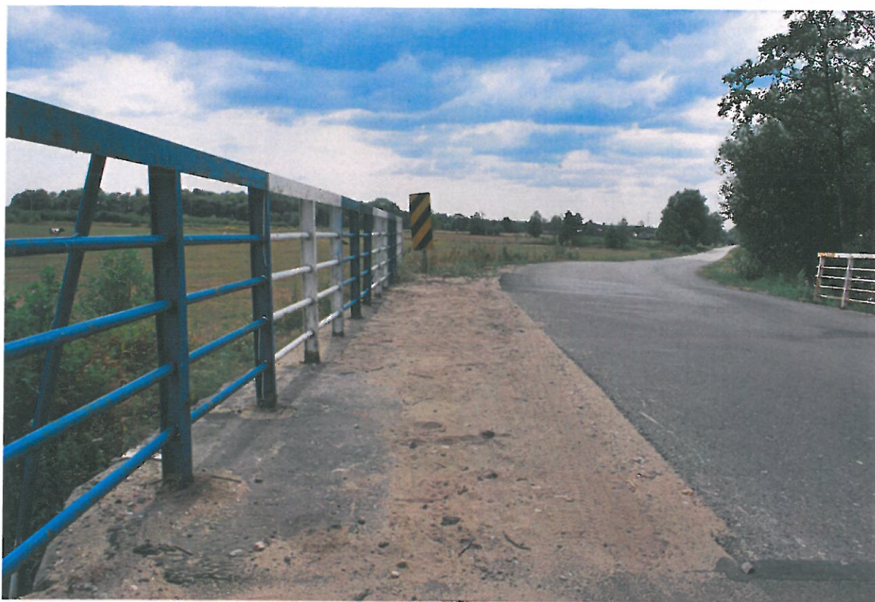
Fot. 7. Zanieczyszczenia, rysy oraz deformacje nawierzchni chodnika.
