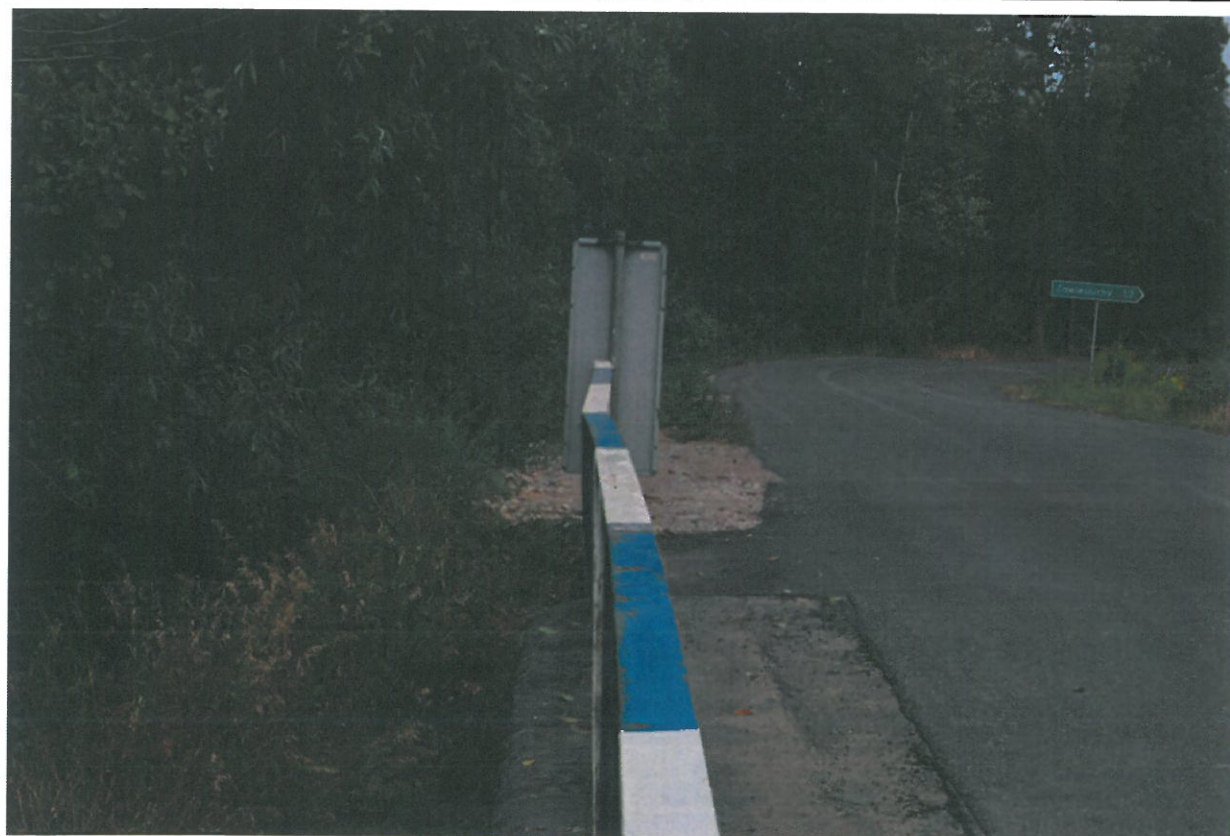
Fot. 10. Deformacja balustrady.
